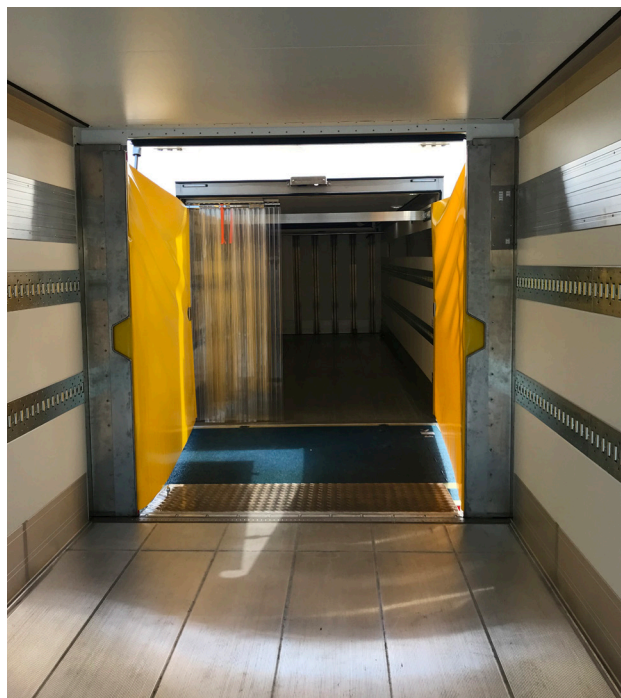
Blick von innen auf die Durchlade-Einhausung von Rohr.
